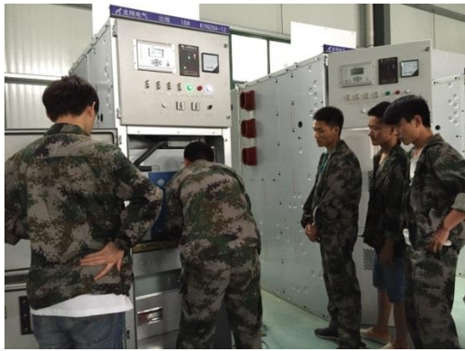
图 4-6 学徒训练电气倒闸操作设备
